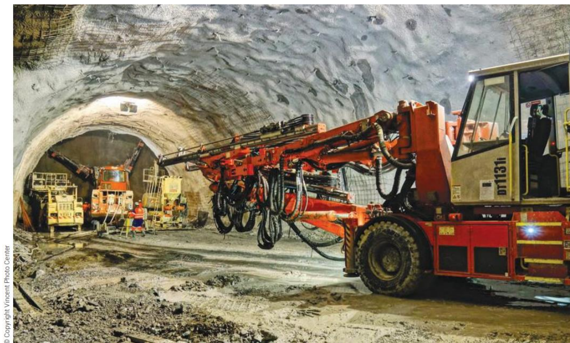
Photographie 5 : Exemple de porteur du système M.O.R.S.E. utilisés pour la partie à l'explosif de la galerie de reconnaissance de Saint-Martin-la-Porte
